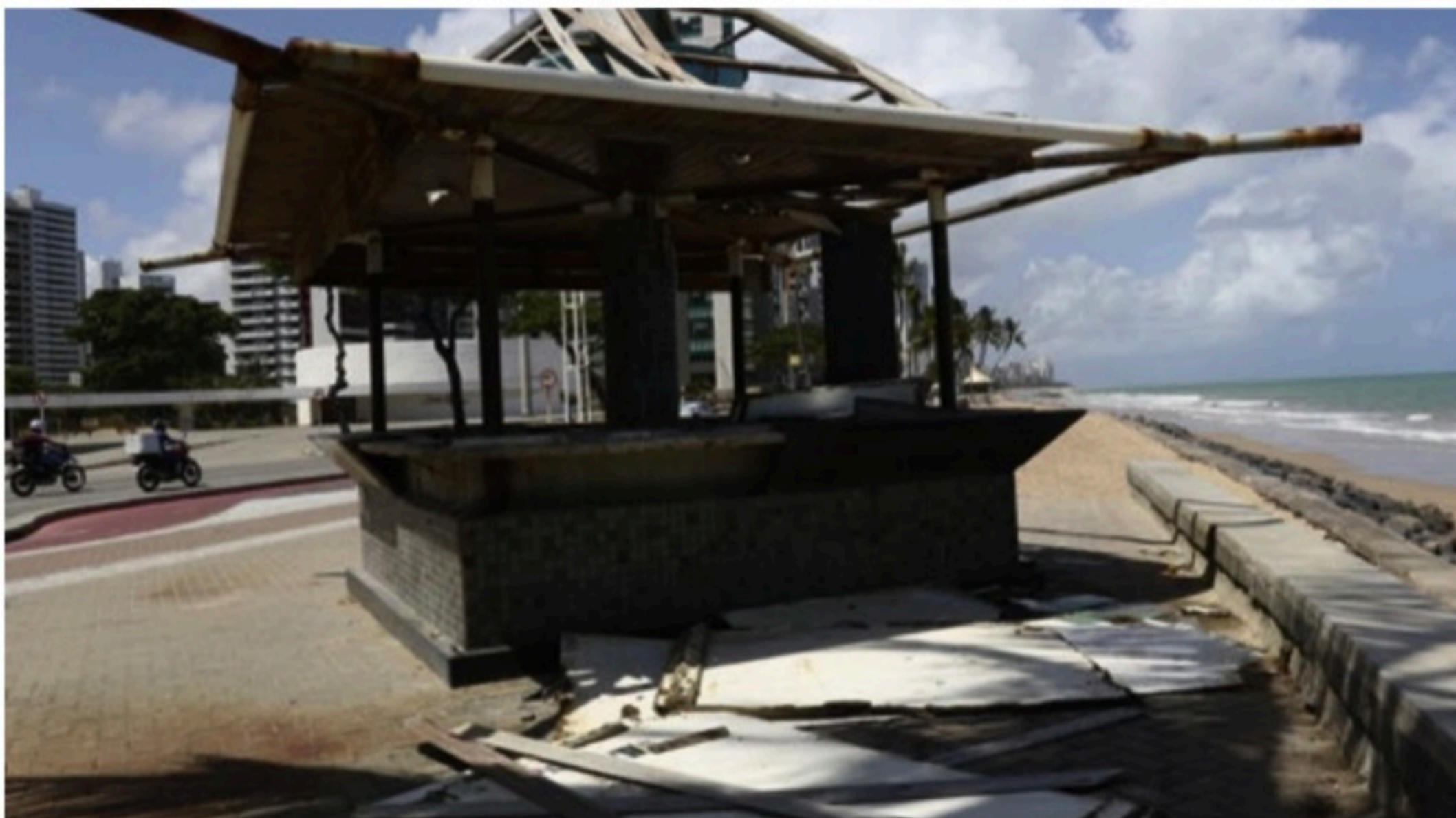
DEGRADADOS Várias das estruturas atuais estão danificadas e passarão por reparo completo, segundo promessa da gestão municipal
