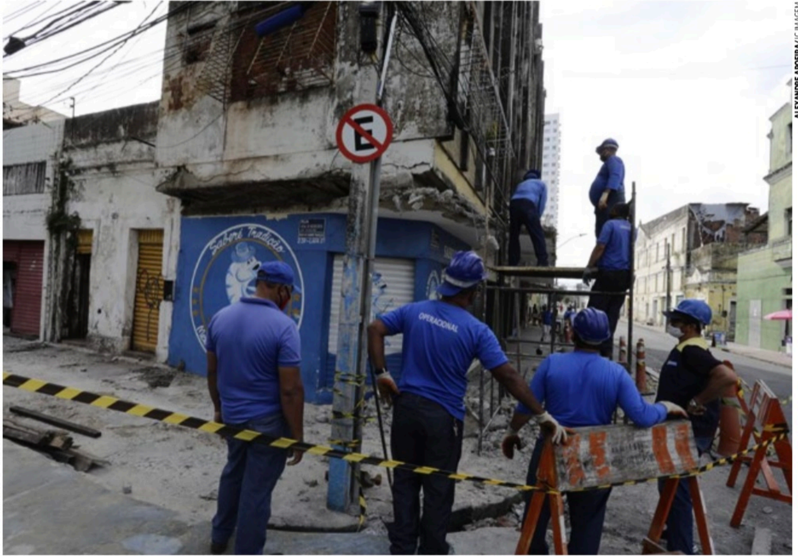
DEMOLIÇÃO Funcionários da prefeitura iniciaram, ontem, os serviços para retirar os restos da marquise do Edifício Leny, que tem 16 apartamentos, e evitar novo acidente no local
