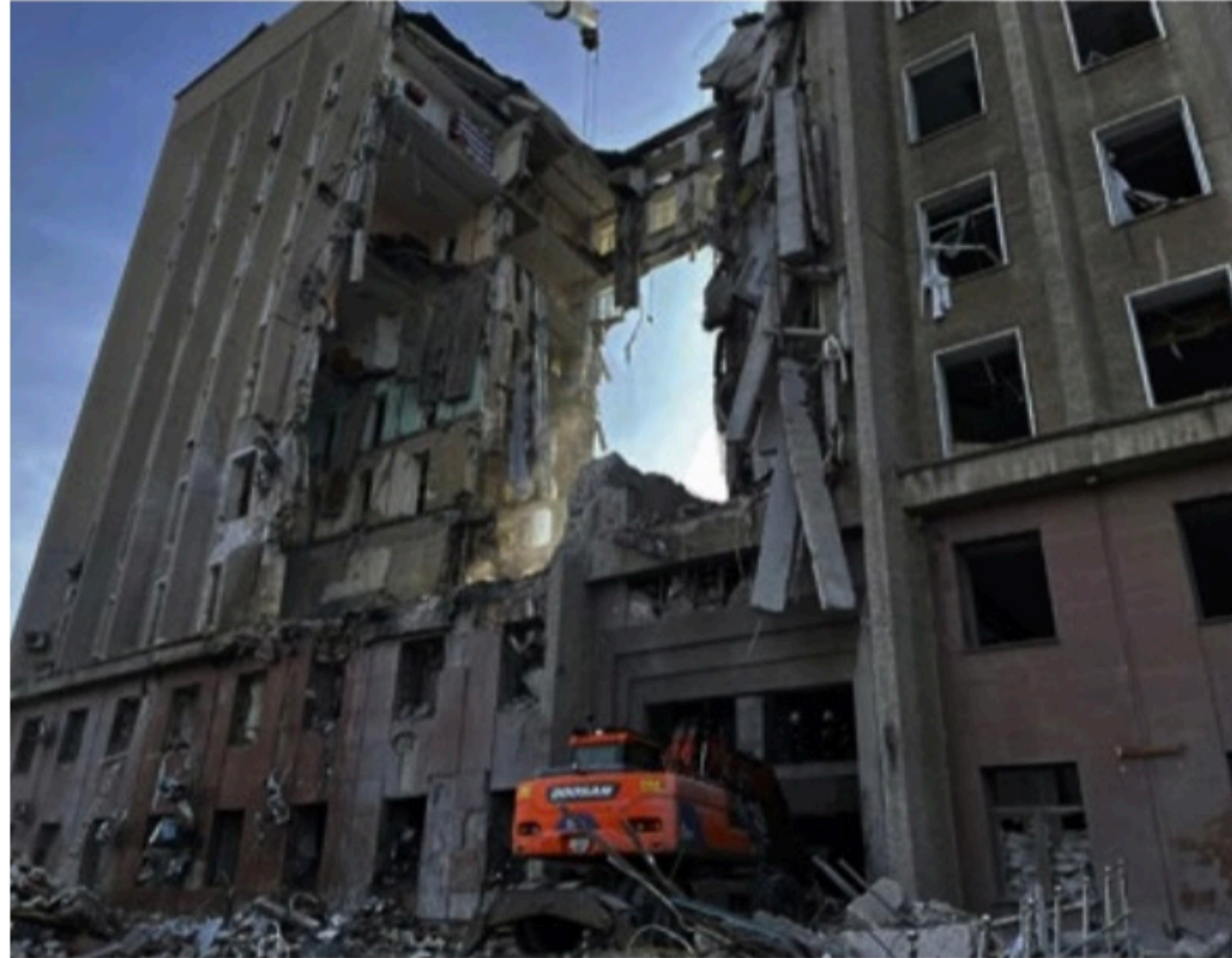
MYKOLAIV Equipes realizam operações de busca nos escombros de um prédio do governo atingido por foguetes
