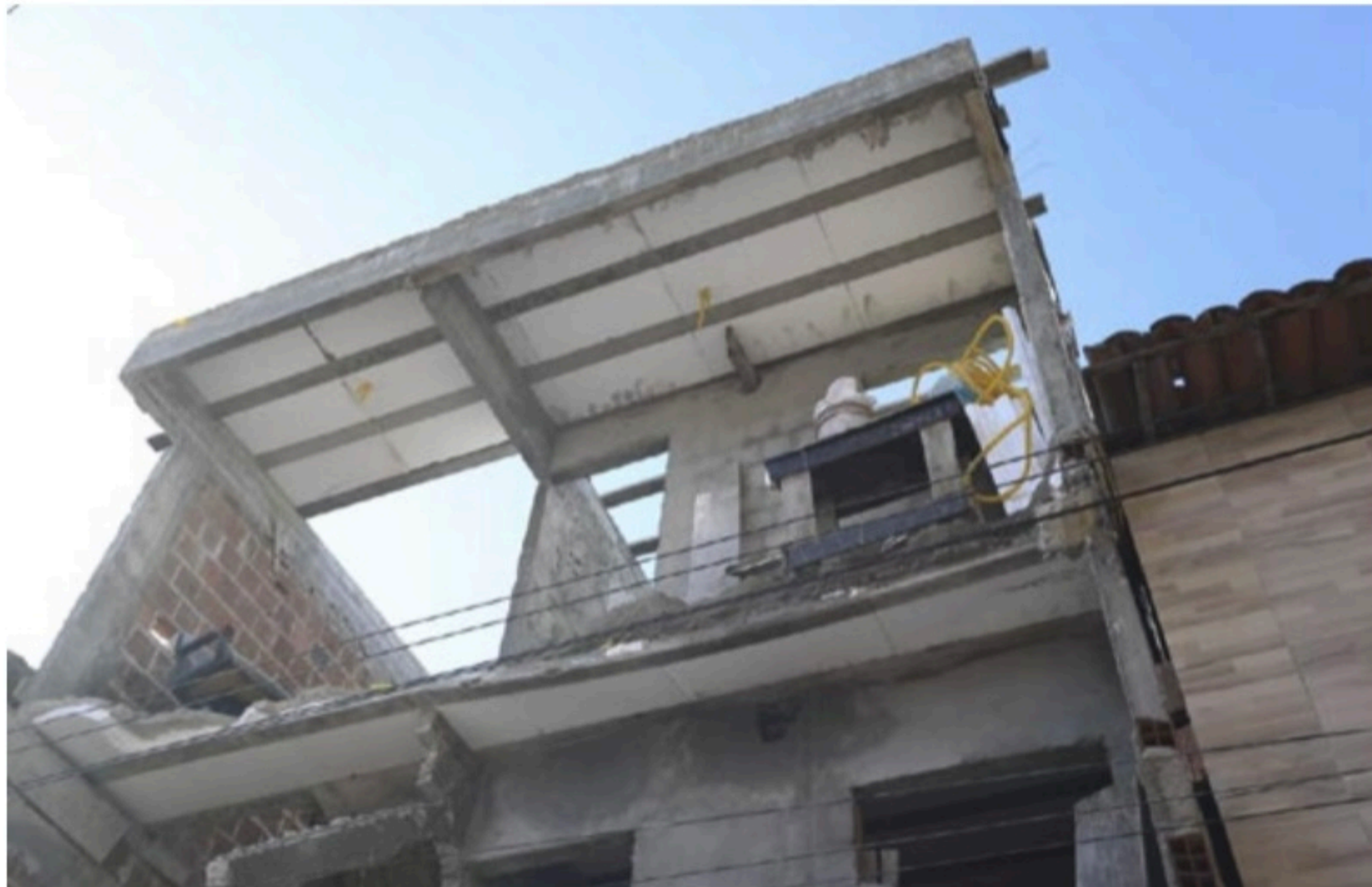
IRREGULAR Equipe da Secretaria Executiva de Controle Urbano esteve, dois dias antes, no prédio e descobriu que não havia licença para construção
