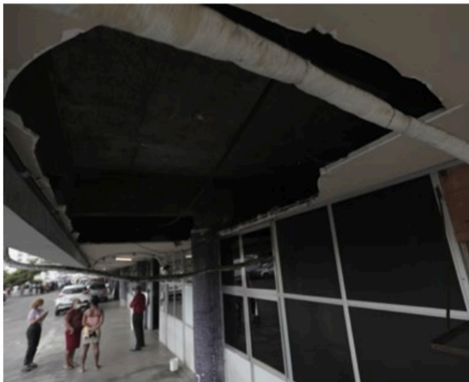
MAIS PROBLEMAS Do lado de fora da unidade de saúde, há ferragens expostas e forros de gesso caídos
