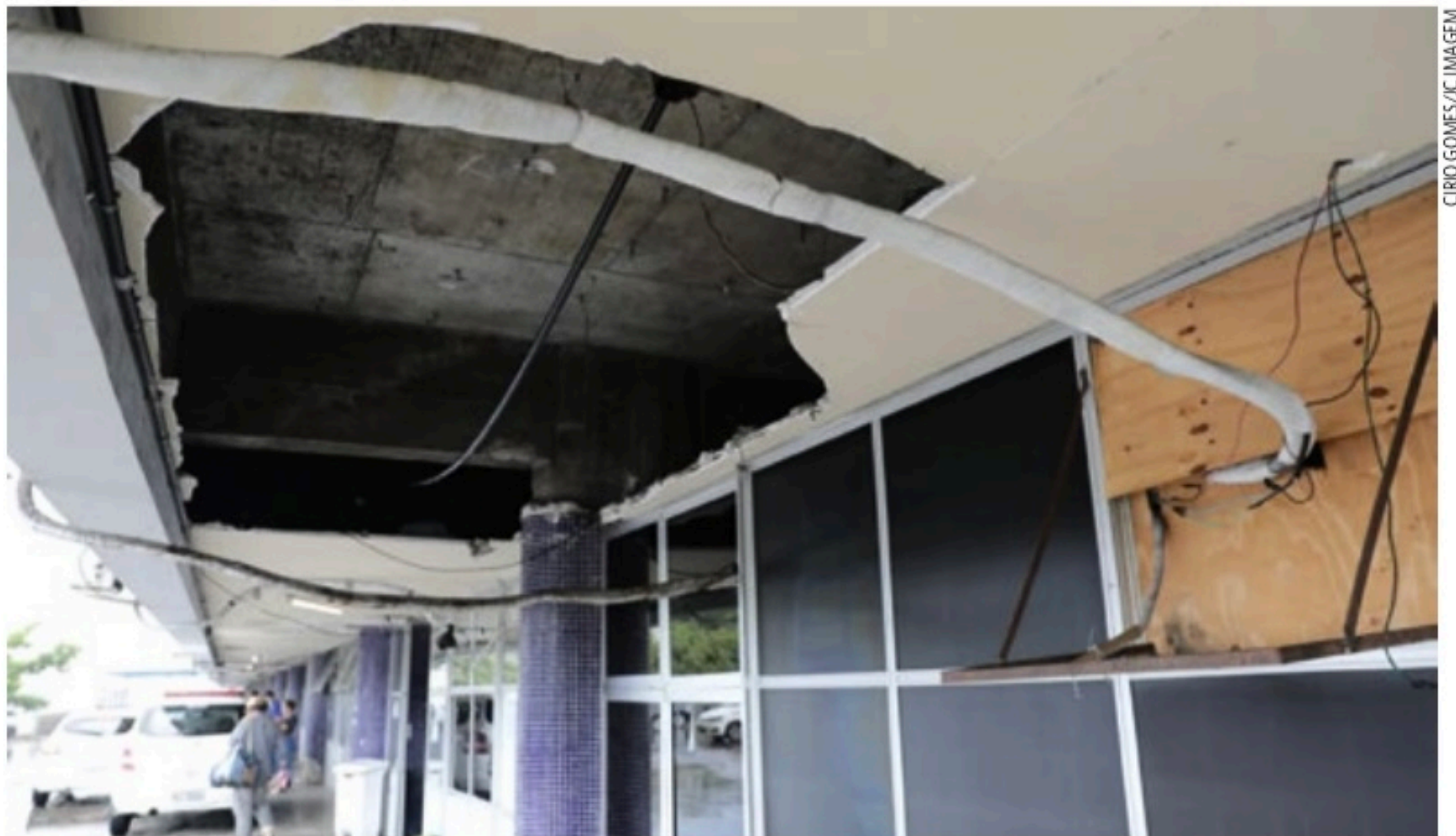
DO LADO DE FORA Área onde ficam os acompanhantes dos doentes também está com problemas estruturais e pode resultar em acidentes
