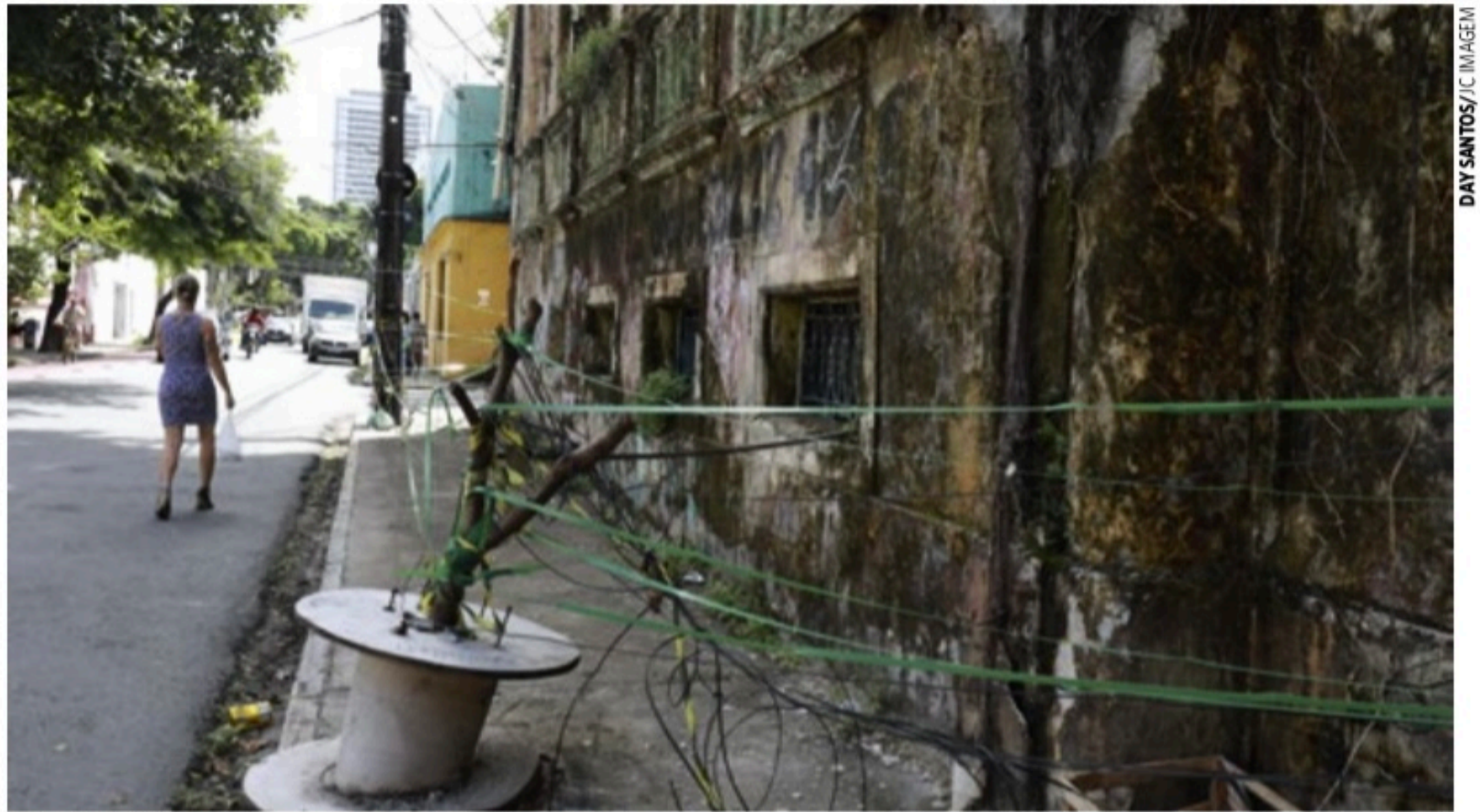
ABANDONO Raízes de árvores e excesso de lodo tomam conta da estrutura, que praticamente não está isolada e segue bastante danificada
