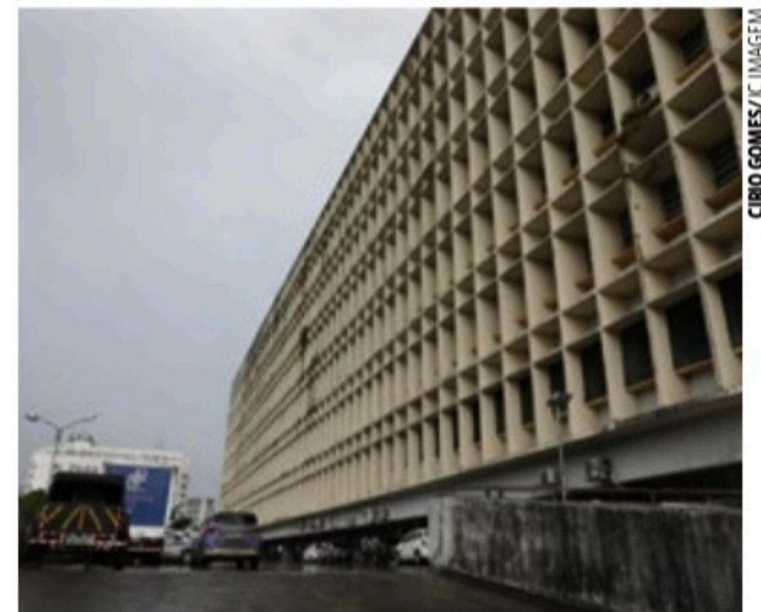
CORRERIA Servidores comiam no refeitório quando parte do forro desabou
