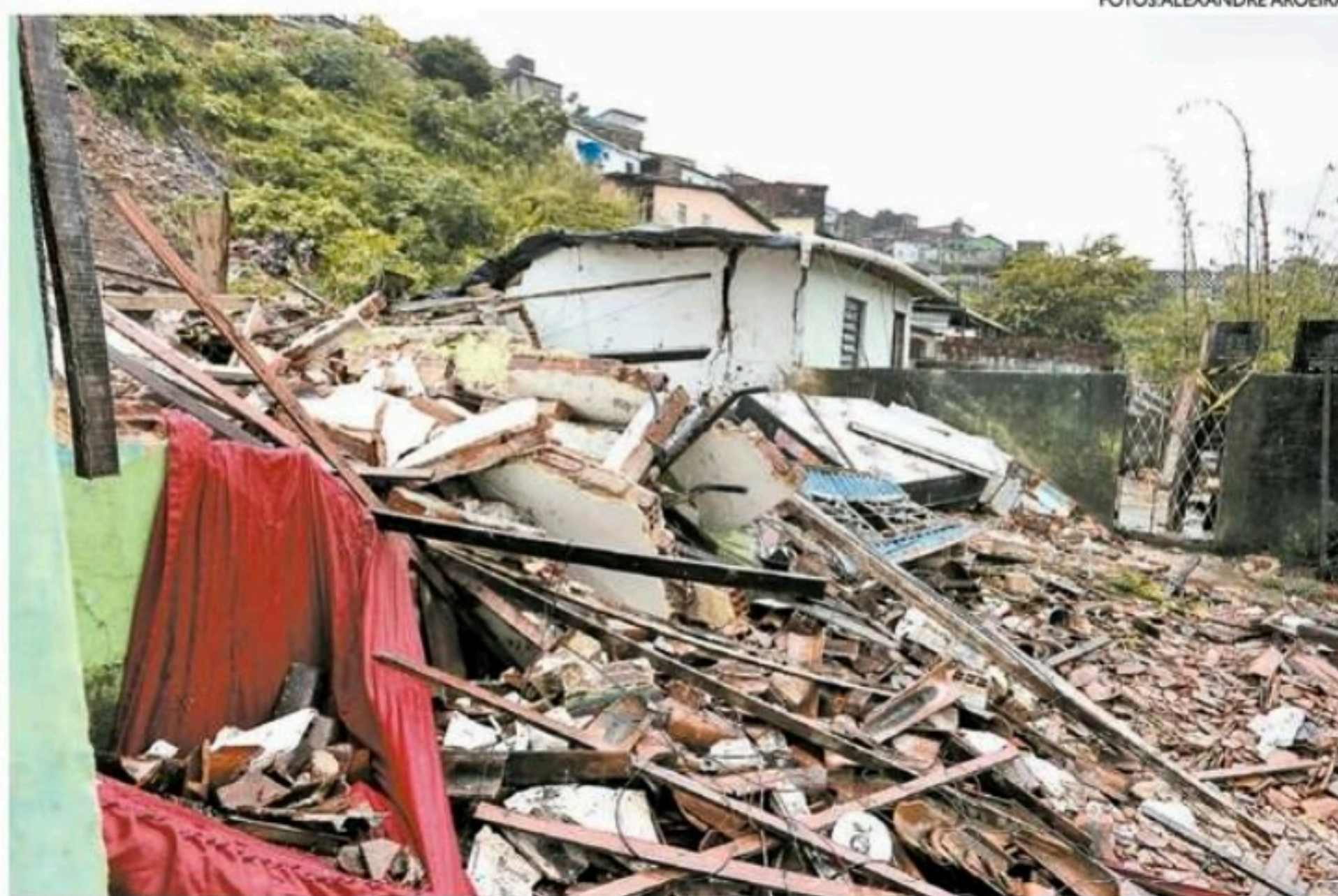
Deslizamento no Alto Santa Terezinha destruiu uma casa e levou à interdição de outras dez moradias
