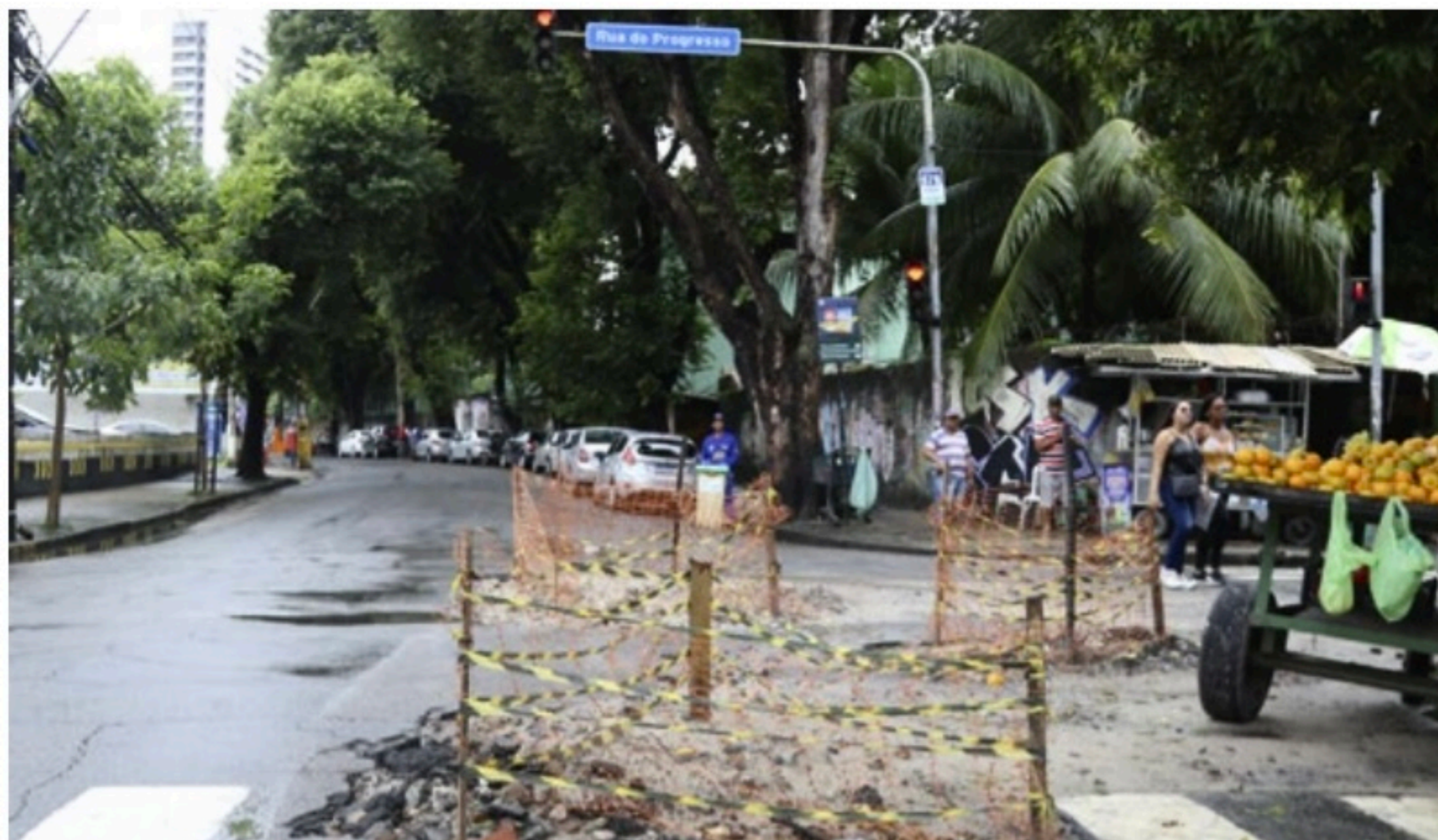
MAIS PROBLEMAS Na Rua do Progresso, também na área central da capital, outros buracos estão dando dor de cabeça aos motoristas
