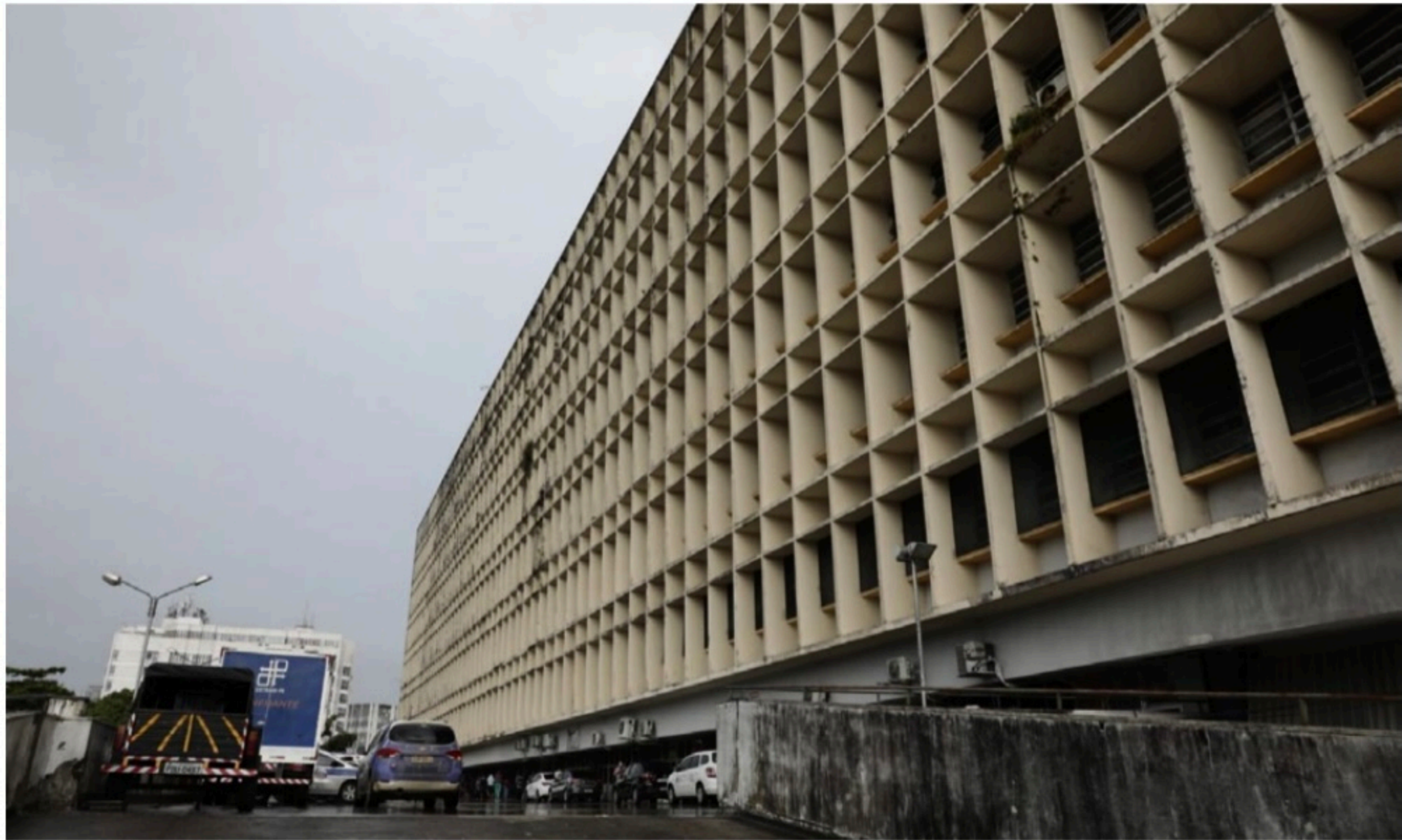
PERIGO Conselho Regional de Enfermagem de Pernambuco avaliou que problemas estruturais na unidade de saúde põem em risco os pacientes e profissionais da área
