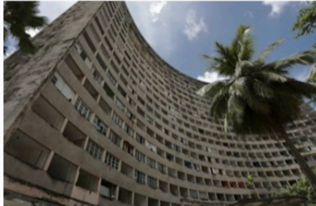
RISCOS Edifício em Boa Viagem está interditado desde março de 2019
