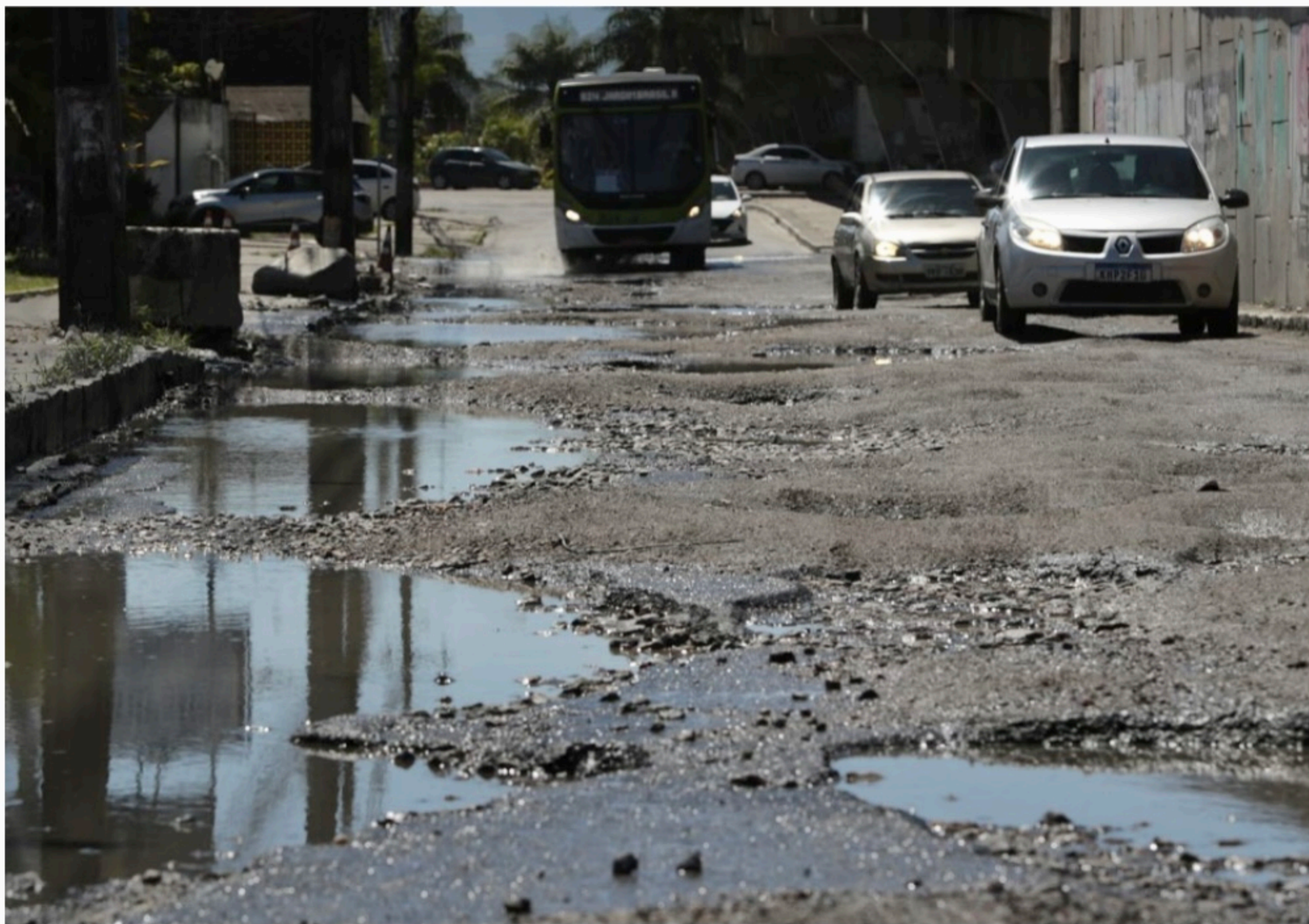
DIFÍCIL CAMINHO No trecho da avenida que ainda vai passar por obras, os motoristas seguem tentando desviar dos buracos espalhados e procurando evitar acidente
