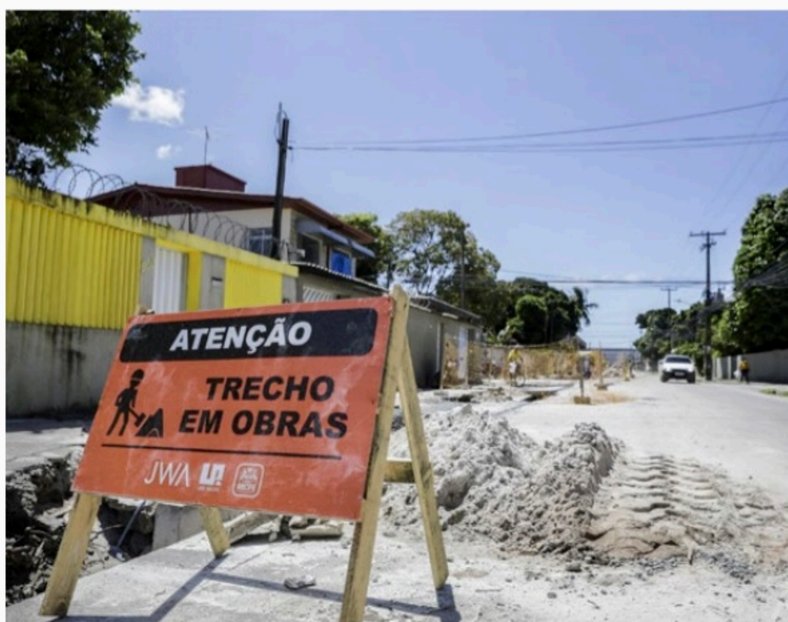
MELHORIAS Vias do Ipsep estão recebendo serviços de drenagem, pavimentação e sinalização viária
