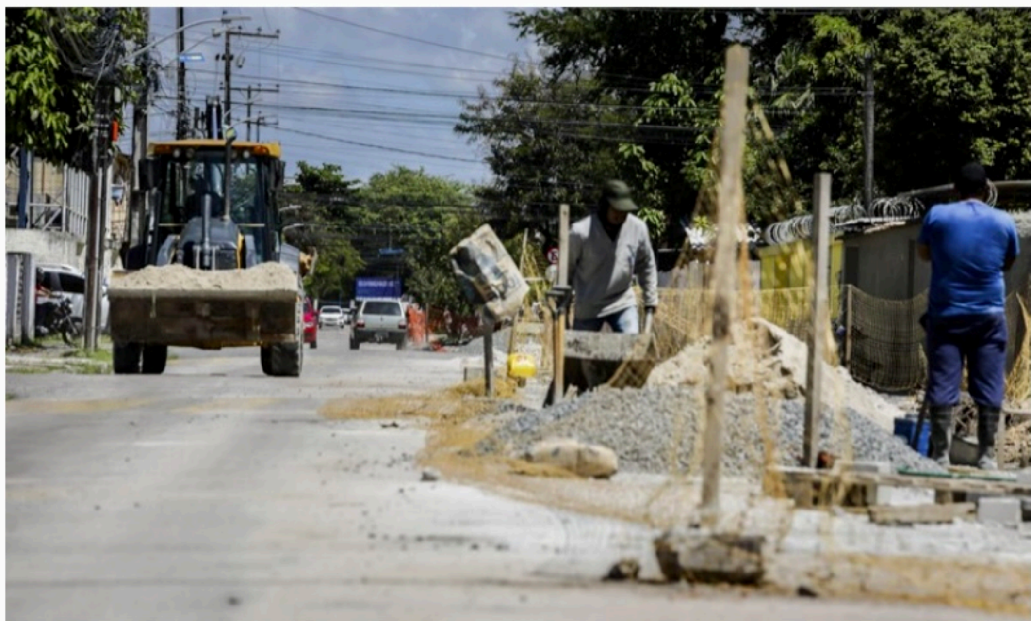
INVESTIMENTO Segundo a Prefeitura do Recife, serão gastos 36,3 milhões nas intervenções de infraestrutura. Obras foram iniciadas em abril
