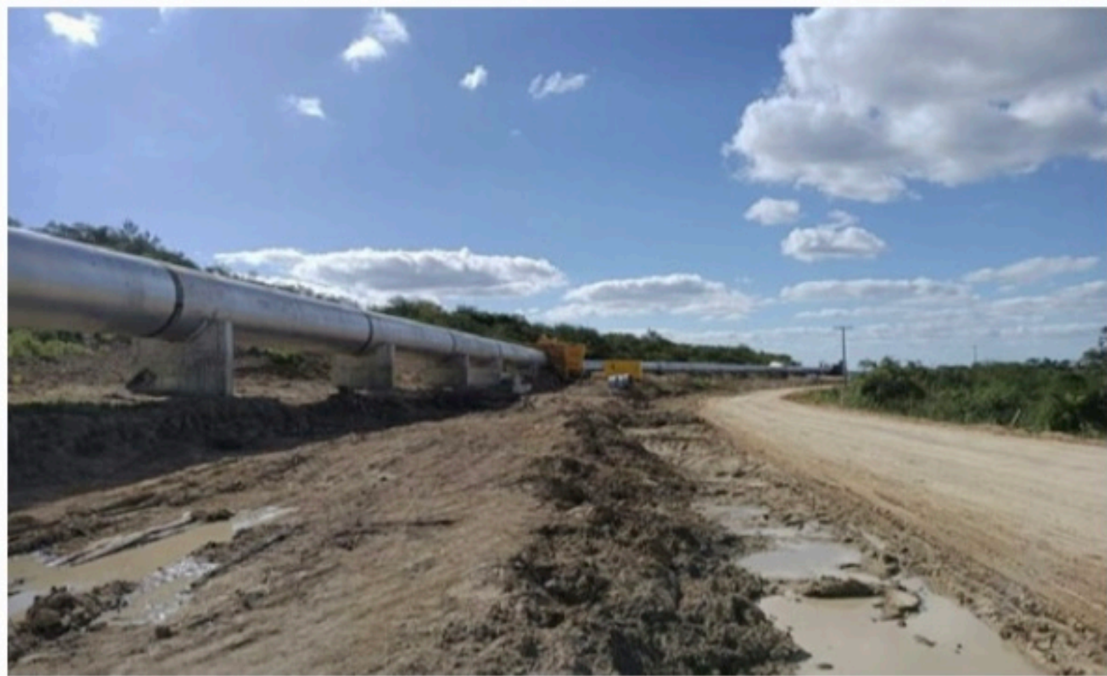
ADUTORA DO AGRESTE Após nove anos de execução, construção corre o risco de parar nos próximos dias
