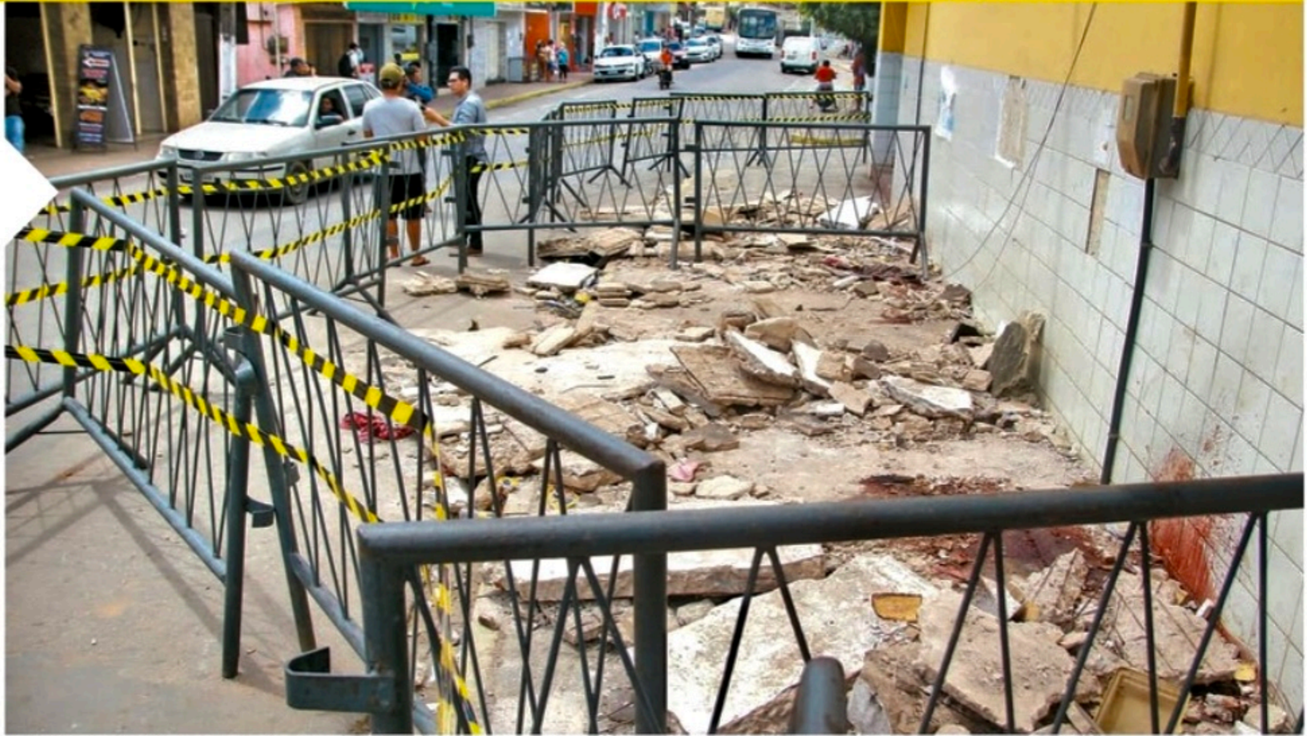
Estrutura, parte de uma bomboniere, desabou na noite de domingo. Além das mortes, pelo menos dez pessoas se feriram
