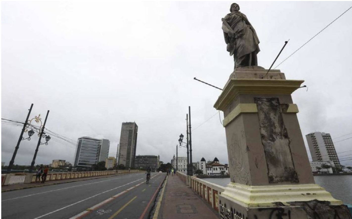
PATRIMÔNIO Bandidos conseguiram arrancar a placa de bronze presa ao concreto da estátua da Deusa da Justiça (Thêmis), na Ponte Maurício de Nassau
