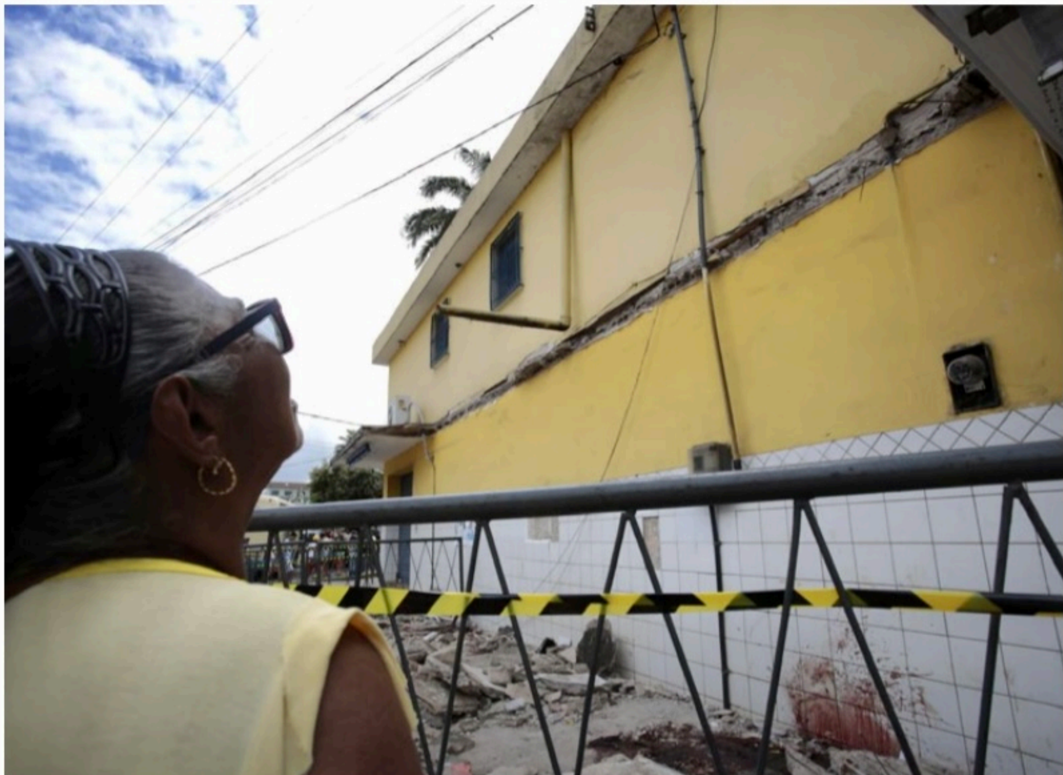
INVESTIGAÇÃO Órgãos, como o CREA-PE, farão perícias no local do desabamento para identificar as causas e responsabilizar os responsáveis pelo acidente
