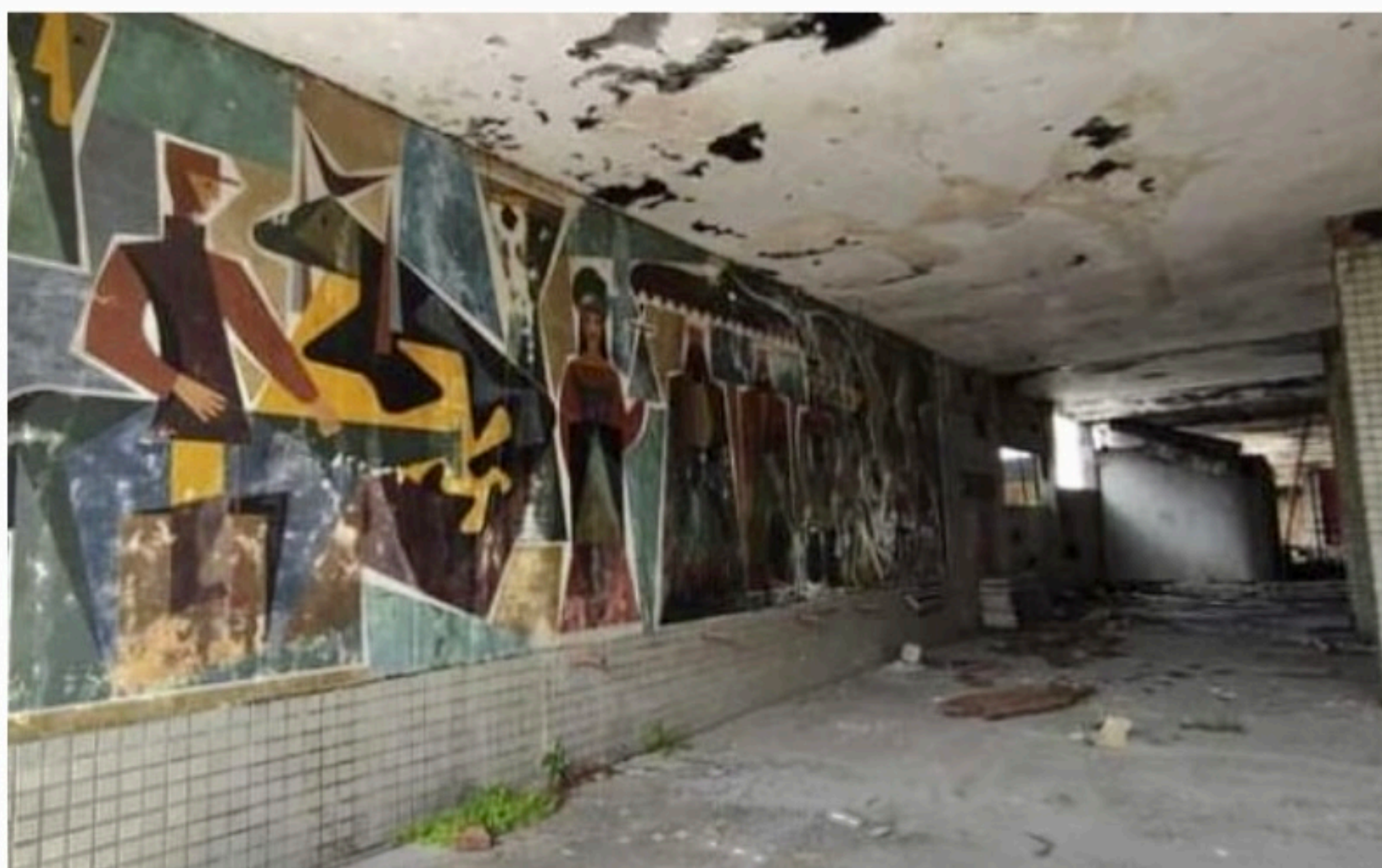
DEGRADAÇÃO Painéis "Folclore" e "Ciclo Econômico", de Lula Cardoso Ayres, que estão em processo de tombamento pela Fundarpe, sofrem com descaso
