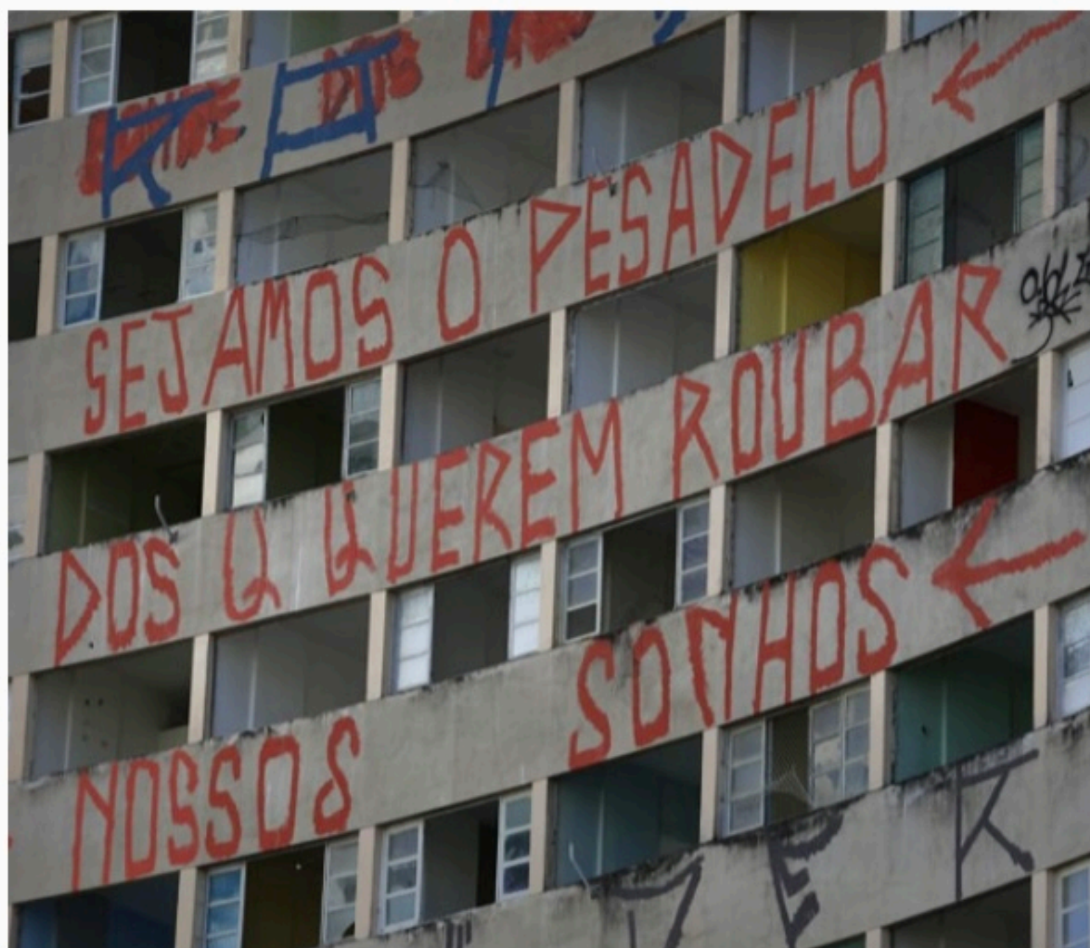
RISCOS Estrutura física precisa de ajustes, mas não corre risco de queda; problema maior é o sistema elétrico
