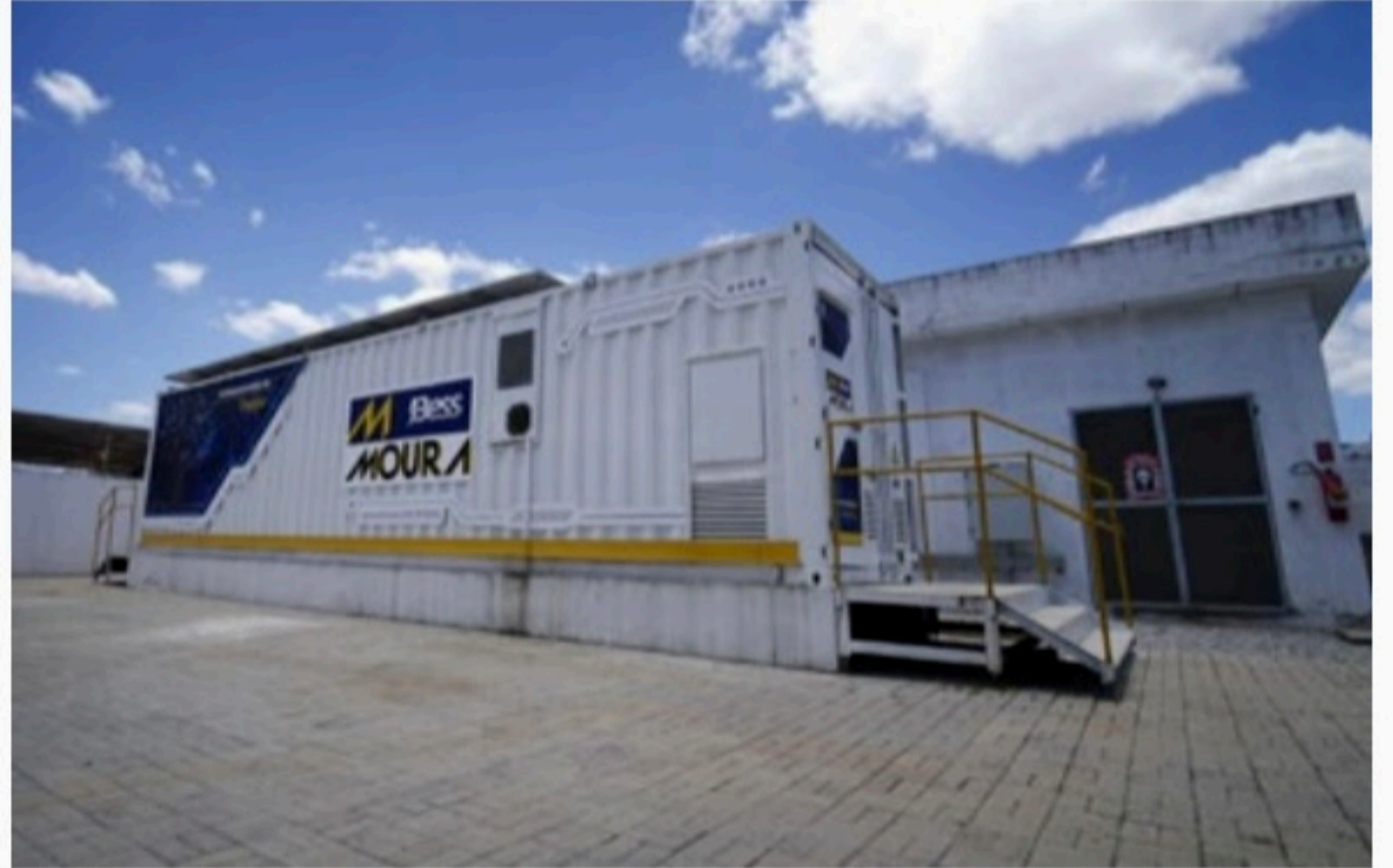
BESS É um projeto da companhia pernambucana que tem a ver com carro elétrico e energia renovável
