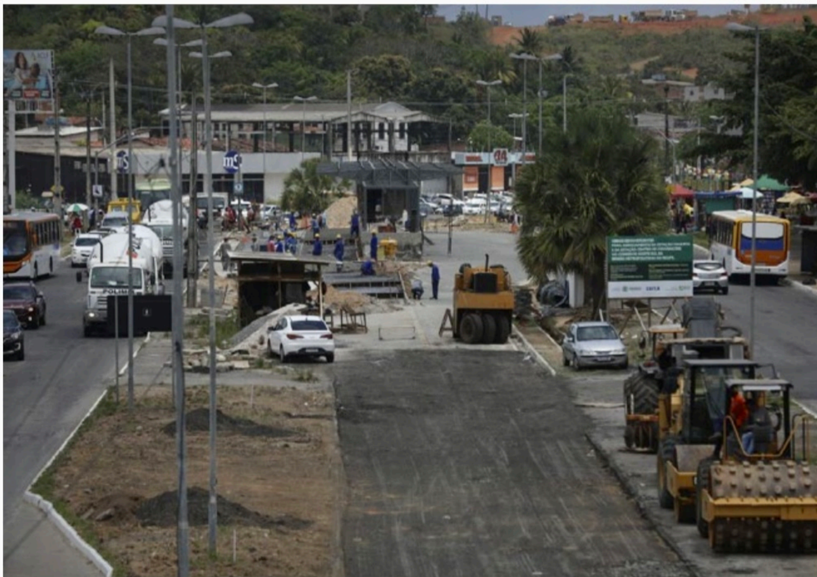
PE-15 Nesta etapa, estão sendo realizadas a fresagem do pavimento, remoção do meio fio e reciclagem da base da pista central de ônibus, no trecho próximo ao TI Pelópidas Silveira
