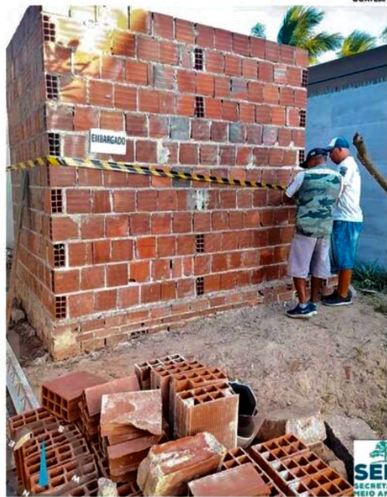
Os moradores denunciaram a construção do quiosque comercial em plena via de acesso à praia
