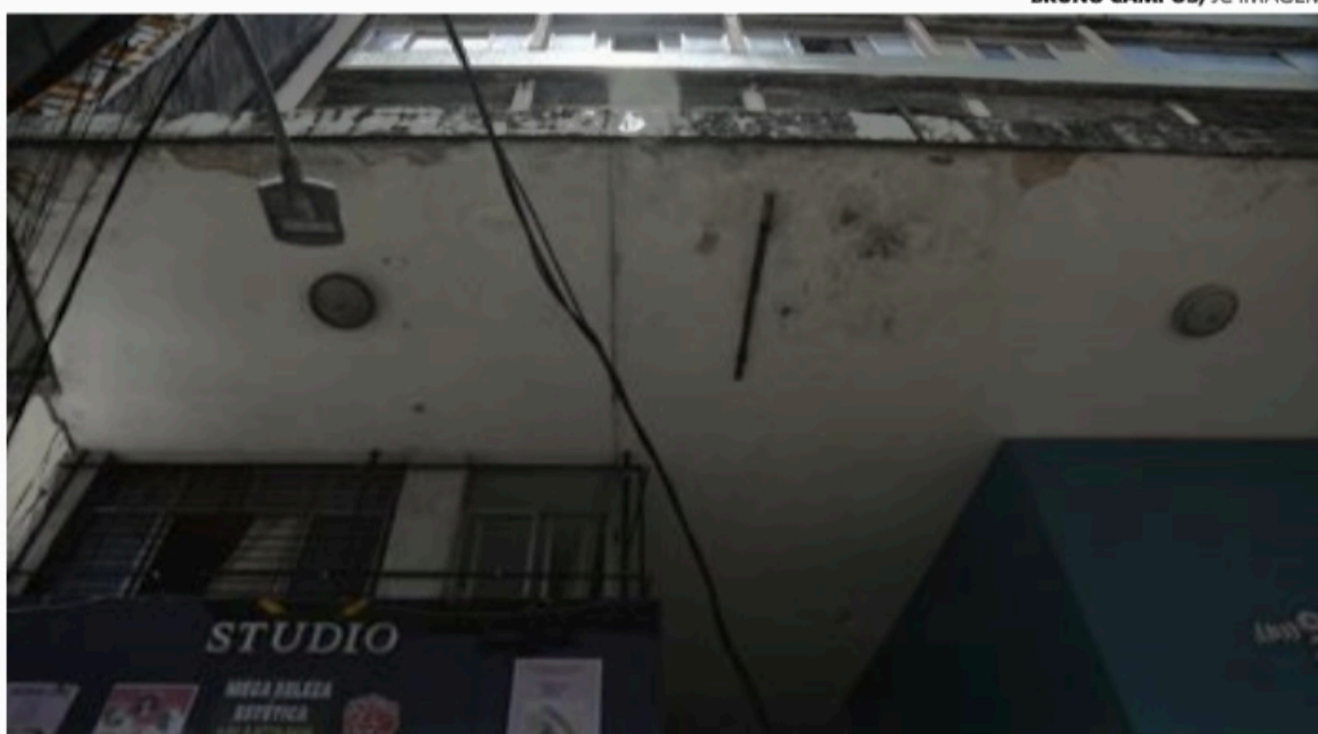
Vários prédios espalhados por duas das principais vias do Recife não passam por manutenção há anos e apresentam algum tipo de risco. Uns mais, outros menos
