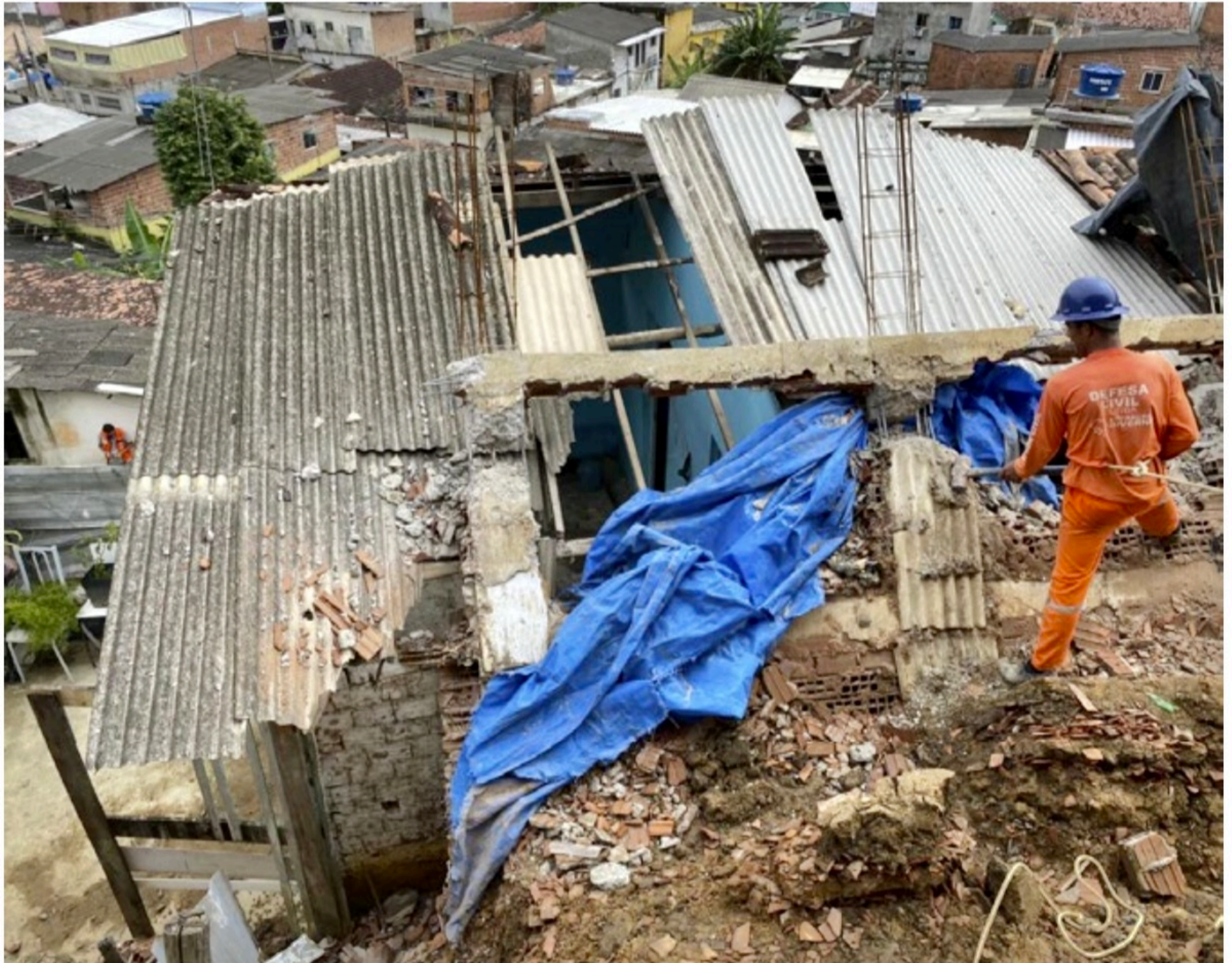
Defesa Civil do Recife em atuação nos deslizamentos
