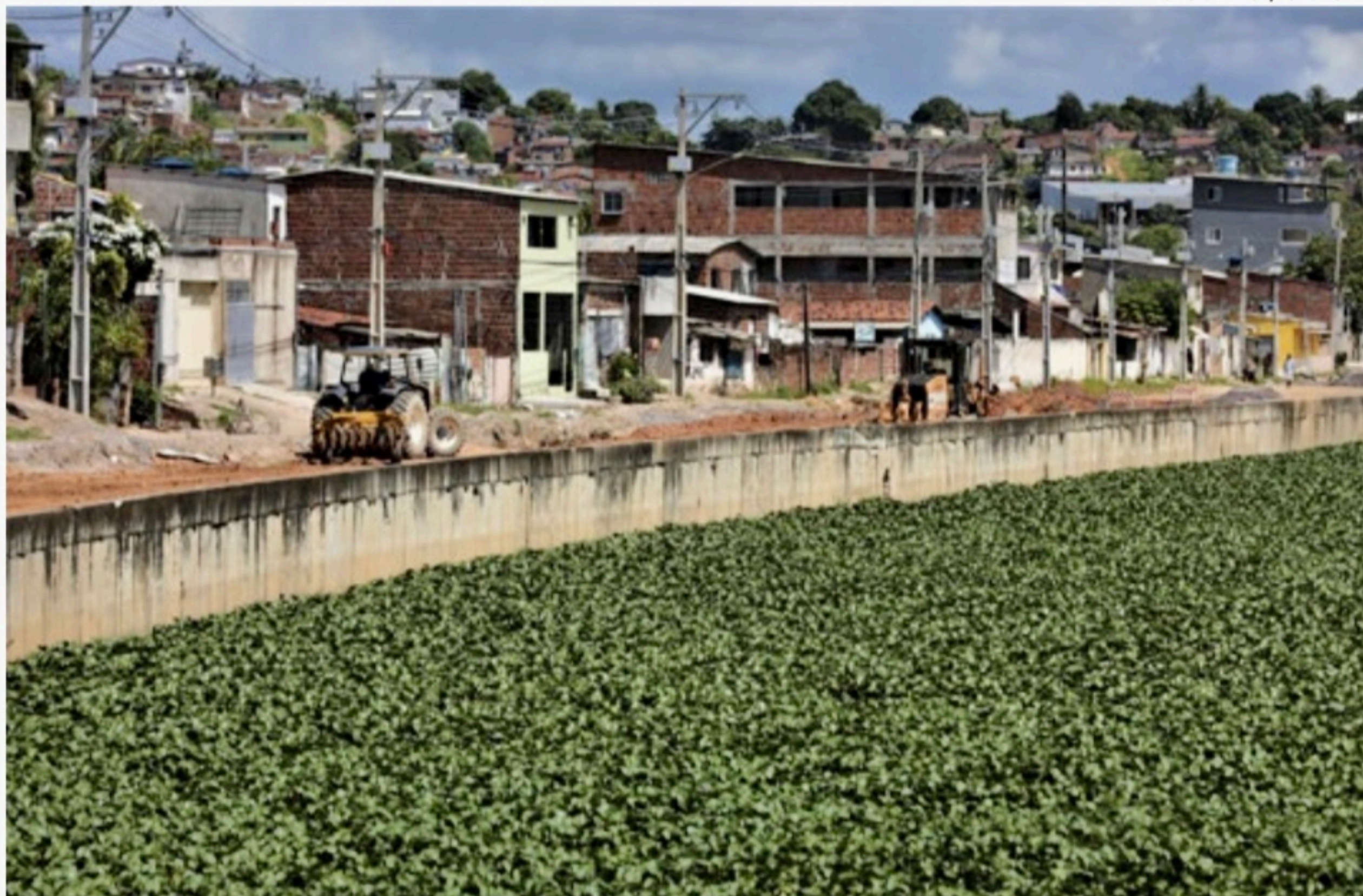
Moradores seguem sofrendo com os impactos da chuva na obra atrasada
