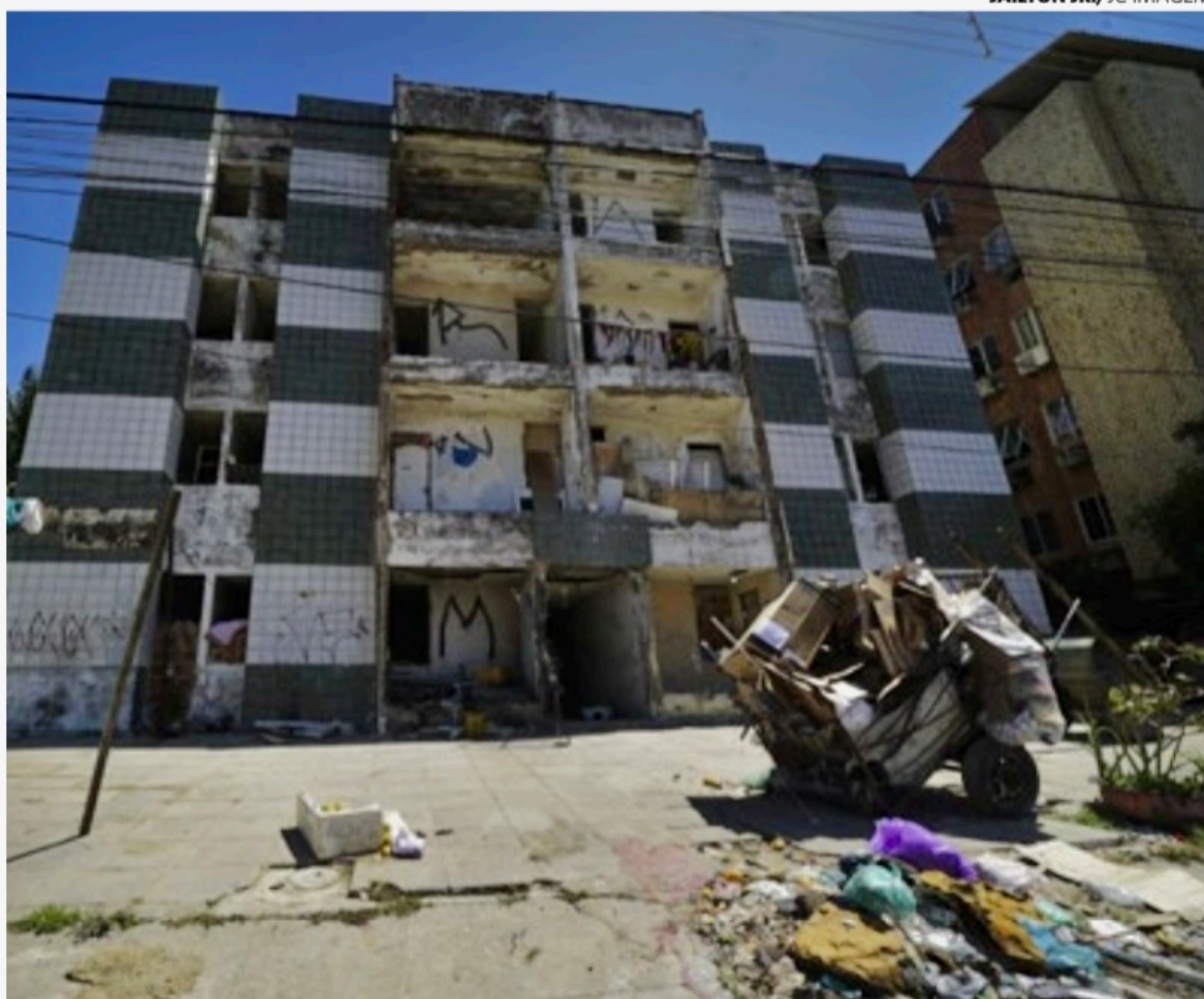
Estrutura do Edifício Marquês Felipe, em Olinda, ameaça cair
