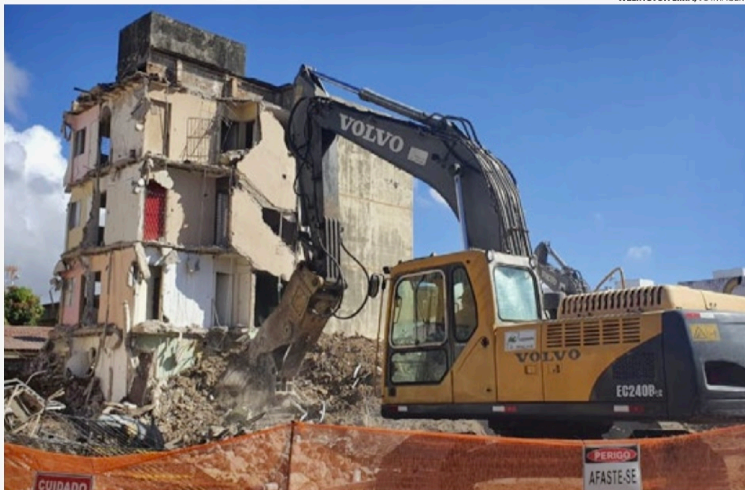
Edifício Leme só foi demolido após parte dele desabar e matar seis pessoas
