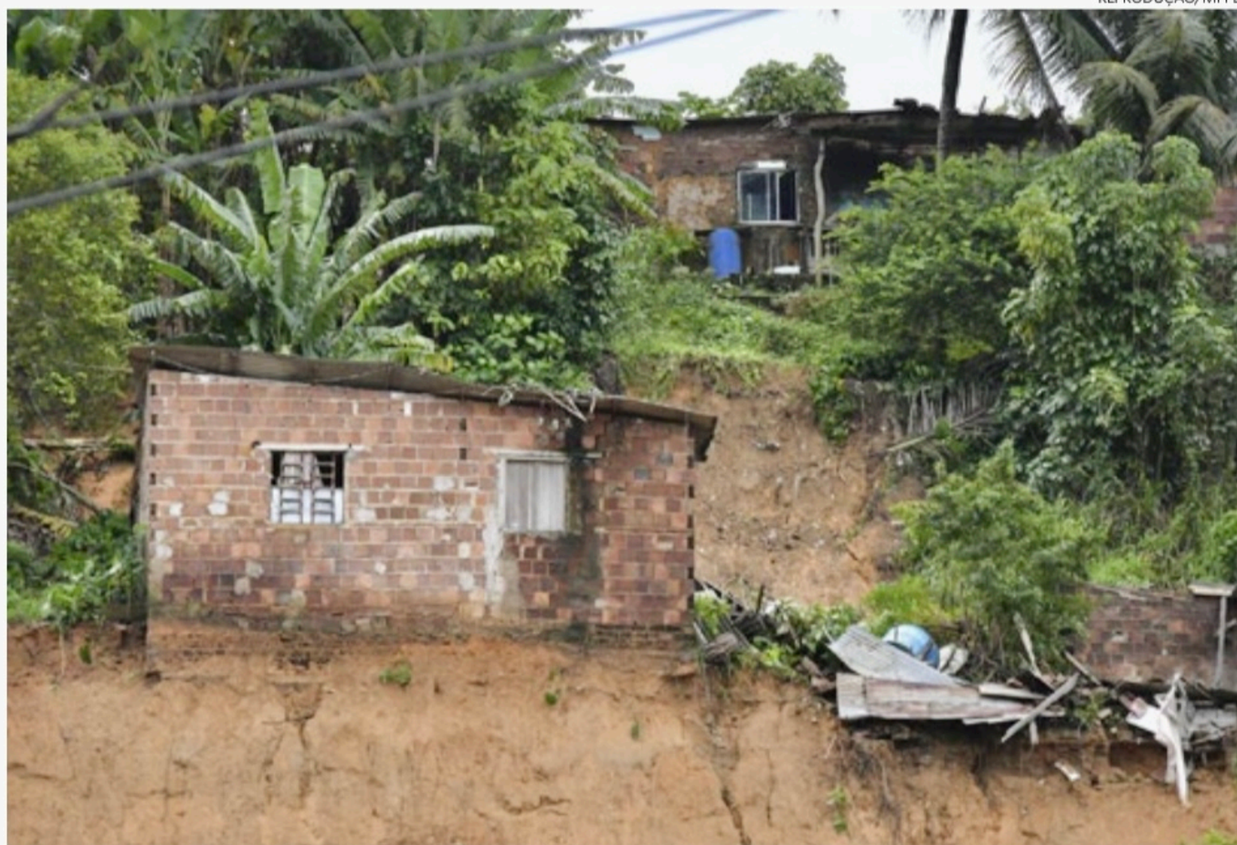
Casa construída em barreira íngreme e com risco de desabamento
