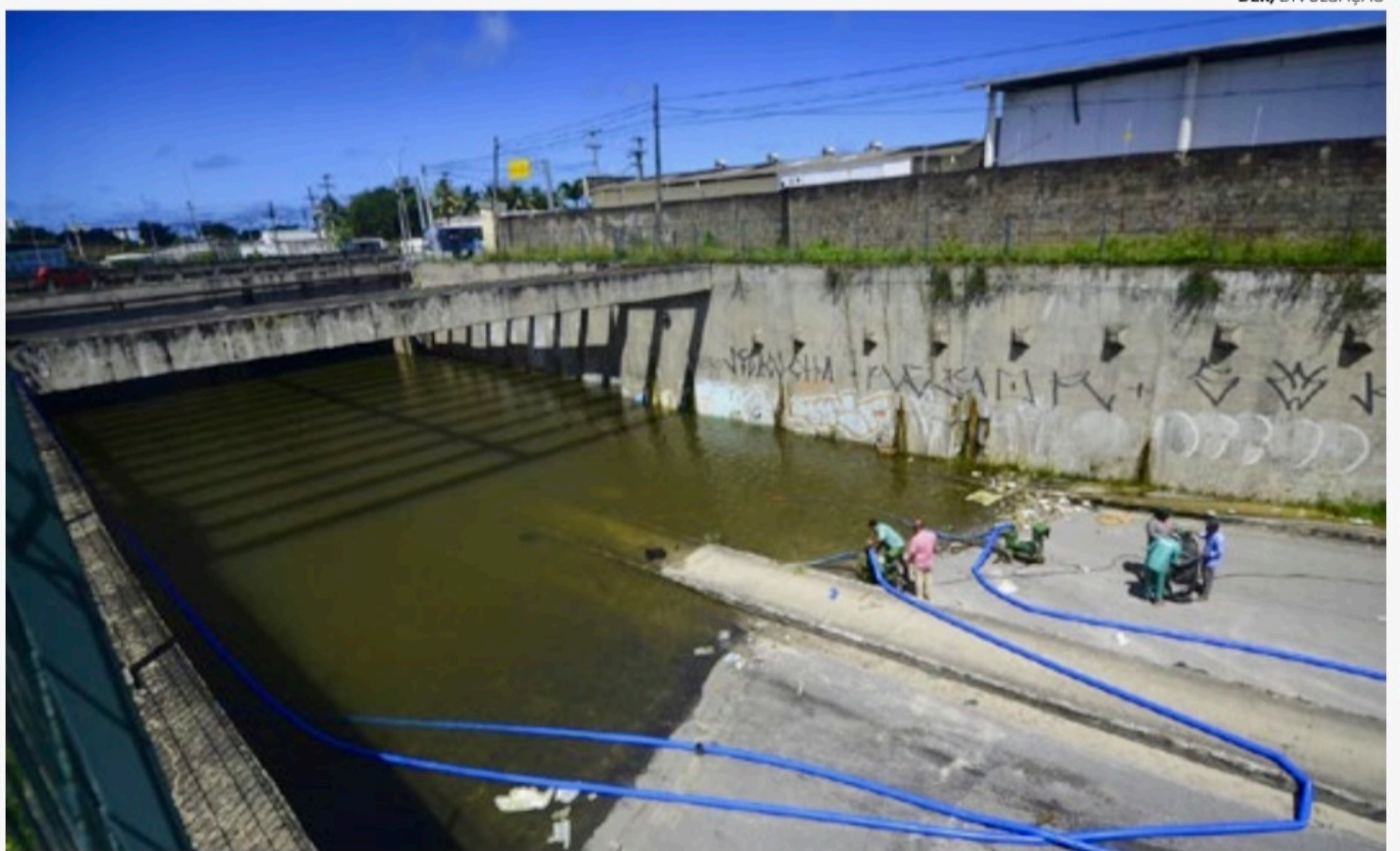
Túnel segue alagando e sendo mal isolado. Situação é inaceitável em tempos da engenharia civil do século 21. Já são duas mortes em menos de um ano
