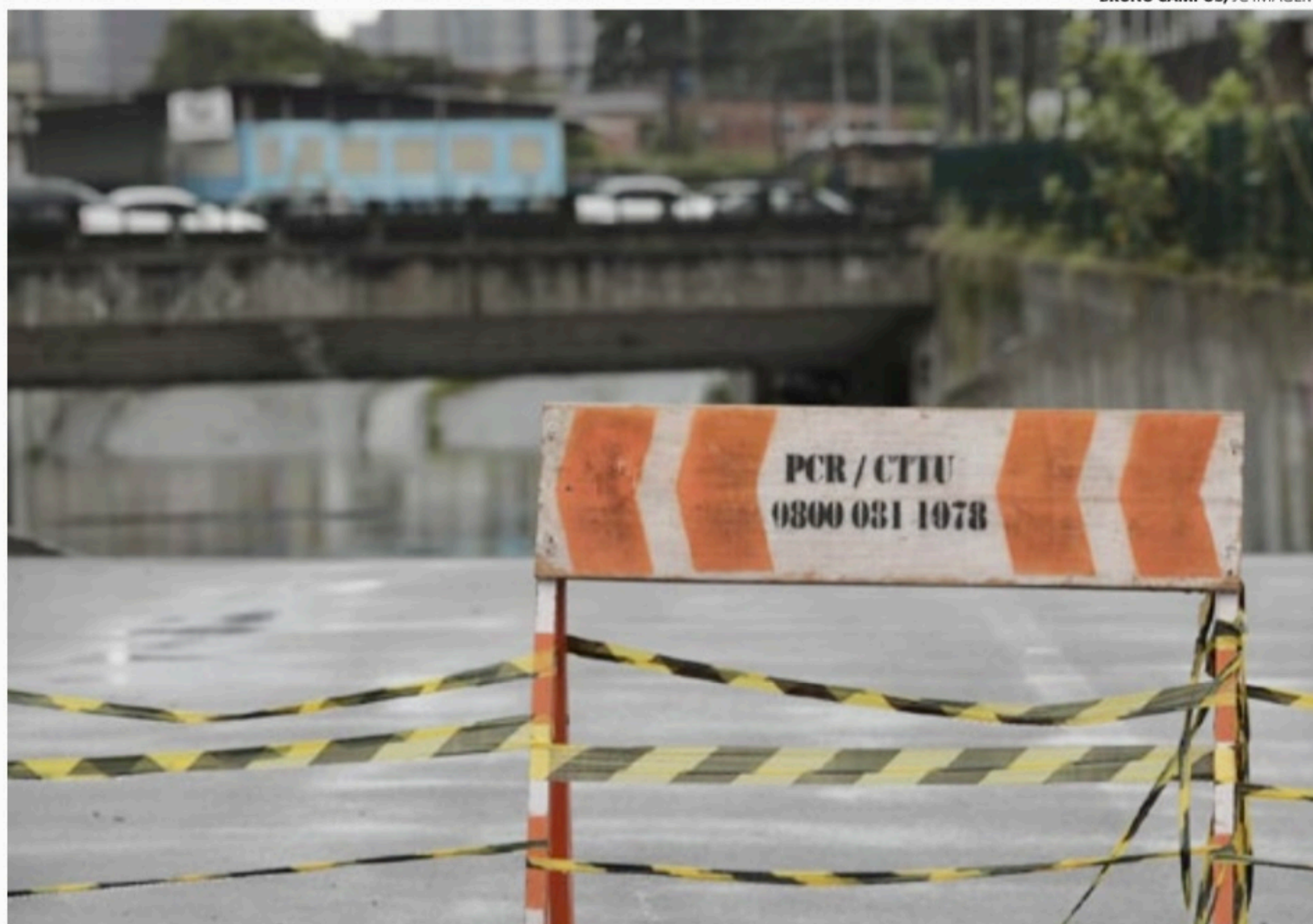
Túnel Felipe Camarão foi interditado na madrugada da terça-feira (27) após acúmulo de água ser registrado
