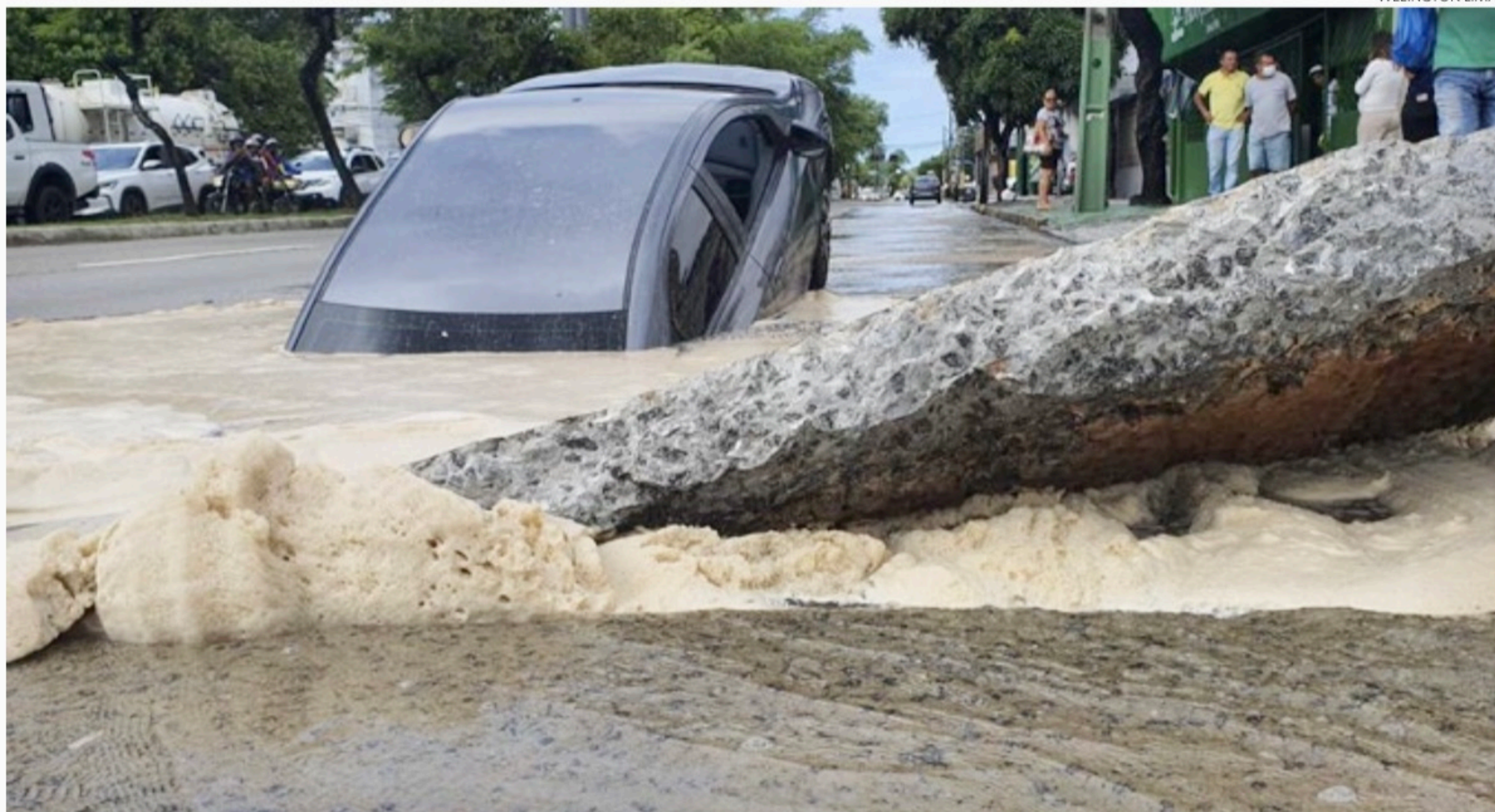
O veículo foi parcialmente 'engolido' após o piso ceder na Avenida Recife, em Areias, na Zona Oeste do Recife. No carro, além do motorista estava uma passageira. Nenhum dos dois ficou ferido
