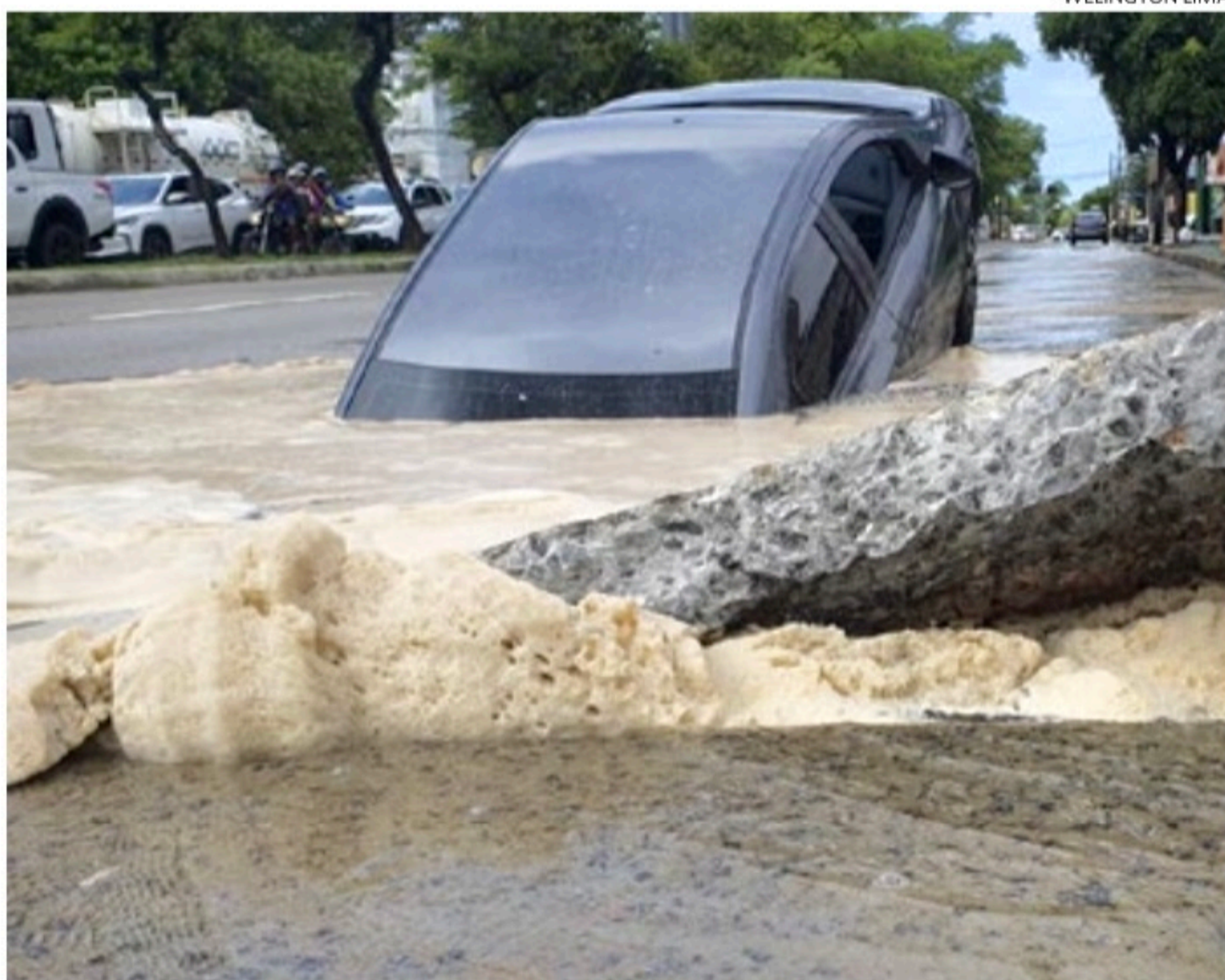
O veículo foi parcialmente 'engolido' após o piso ceder na Avenida Recife, em Areias, na Zona Oeste do Recife. No carro, além do motorista estava uma passageira. Nenhum dos dois ficou ferido
