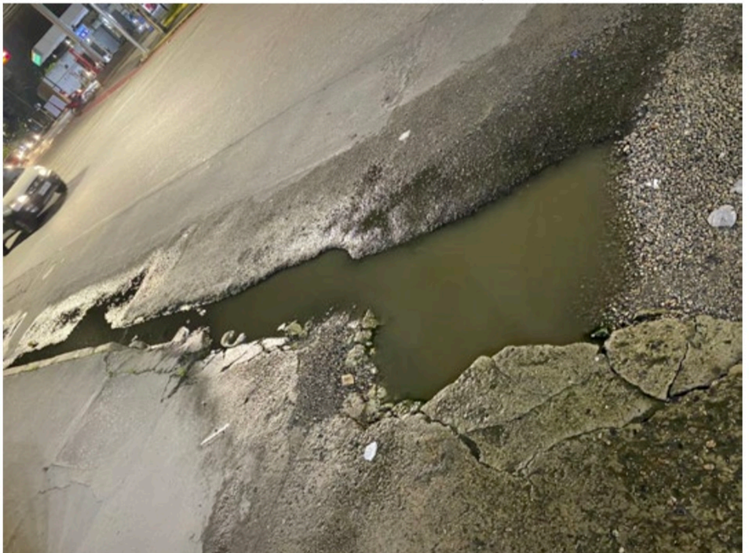
Buraco na Avenida Ayrton Senna
