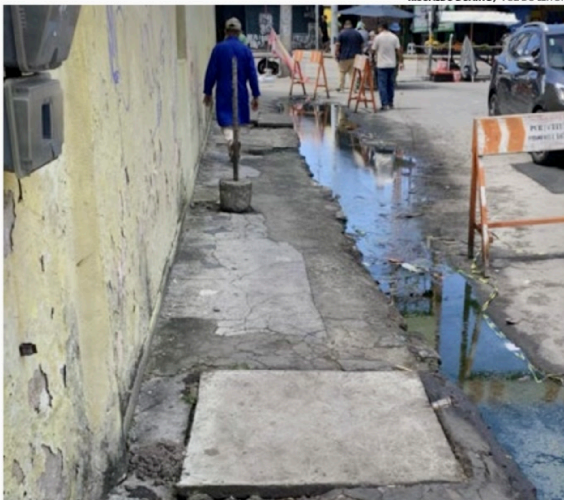
Esgoto estourado no bairro de São José
